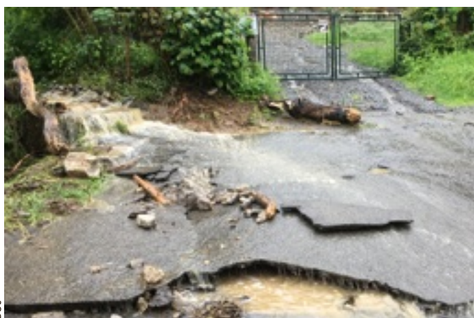
L'aqueduc va être élargi et les tuyaux en béton remplacés par un fossé.
